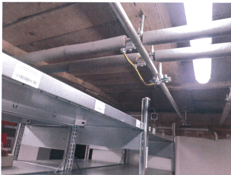
Bild 9: Einbindung Potentialausgleich Hauptgasleitung
